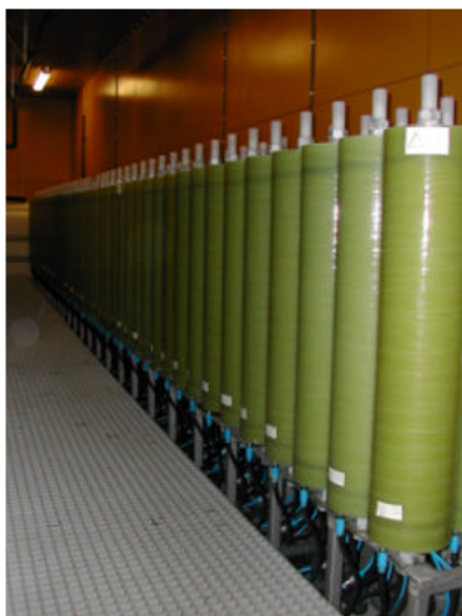
Figur 51. RO-membraner i parallell (foto BB)
