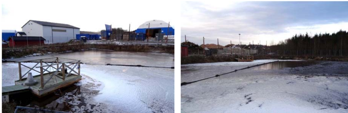
Figur 36. Luftet lagune med to overflateluftere (foto BB)
